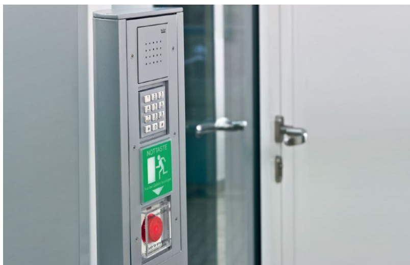
SafeRoute-säkerhetssystem för utrymningsvägar
